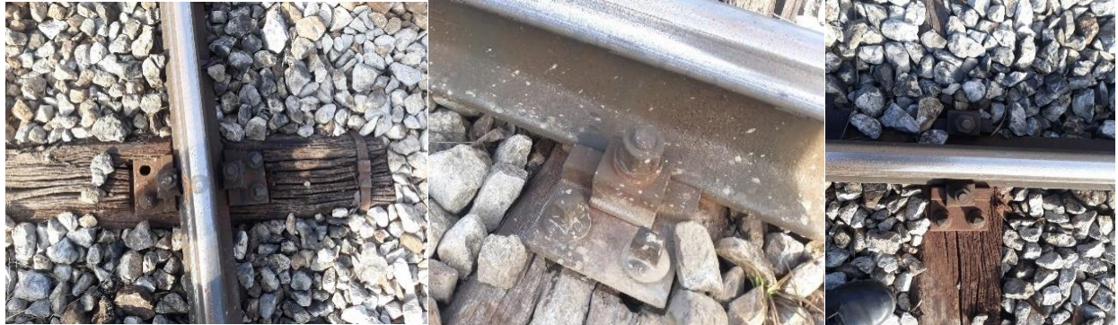
Слика 3.4.2.3: Изглед причврсног колосечног прибора (извор: „ИЖС“ а.д.)
